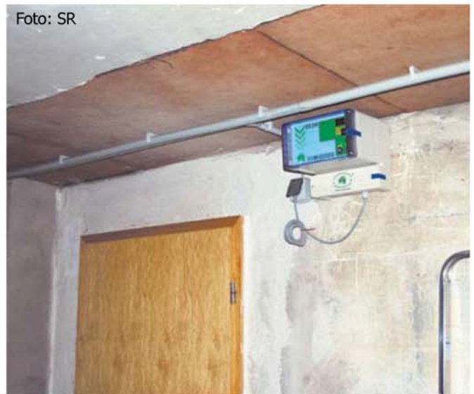
Das BHS-Mauerentfeuchtungsgerät wurde direkt an der Kelleroberseite installiert. Dank seiner Wirkungsweise ist die Feuchtigkeit in Mauern und Fußboden stark zurückgegangen.
