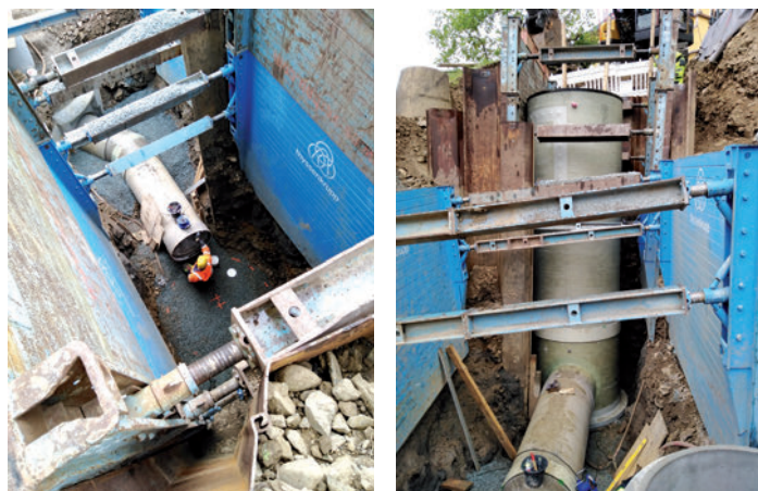
Anbindung und Einsatz des Energieumwandlungsschachtes (S4) im Seminargarten, Gymnasium Zschopau
