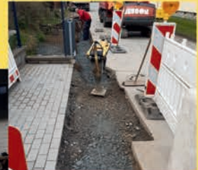
Zuleitung Funkmast Neue Heimat
